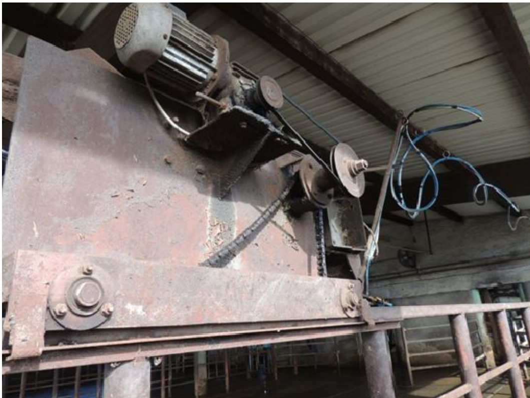
16. Berendezést működtető szerkezet védőburkolat nélkül kb. 1,8 m magasságban.
