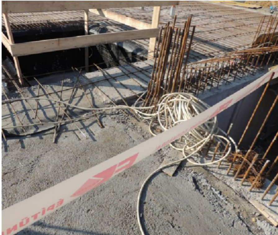
9. Szabálytalan, ideiglenes kábelvezetés a vasalaton.
