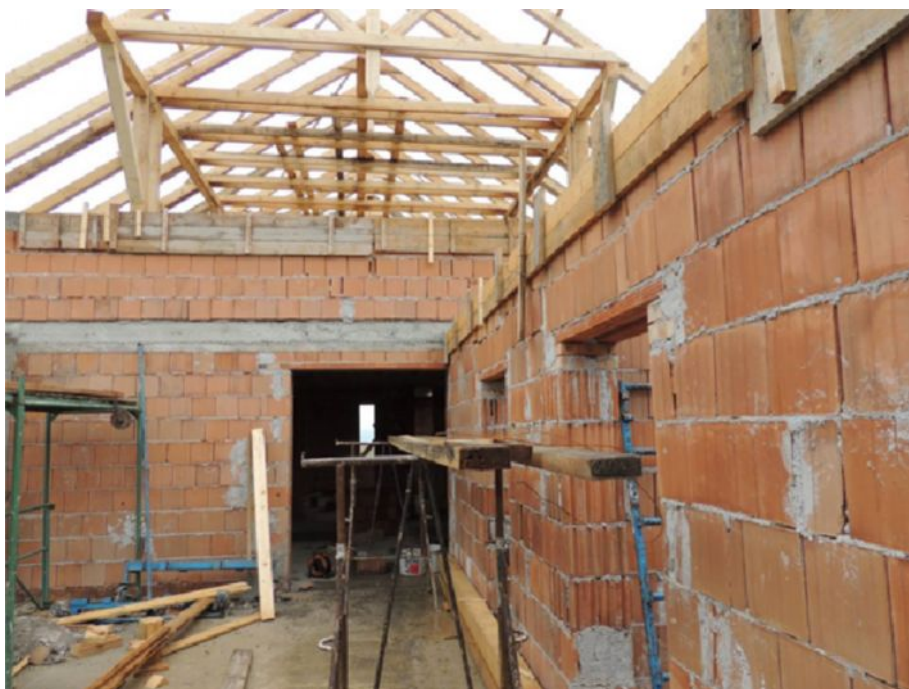
10. Szabálytalan munkaszint kialakítás.
